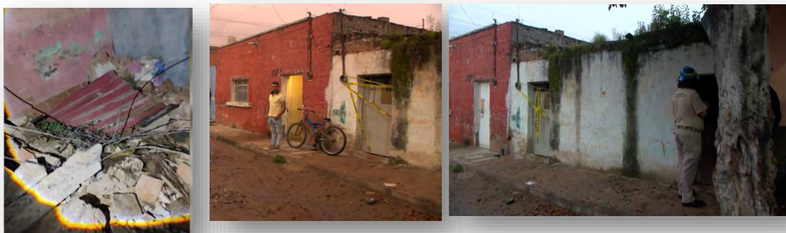
Figura 5 Colapso de vivienda y condiciones de humedad en calle durante temporal de lluvias. Fuente: Nmas 2024.
